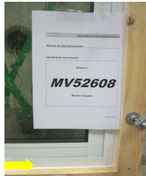
Zona de filtración de agua
