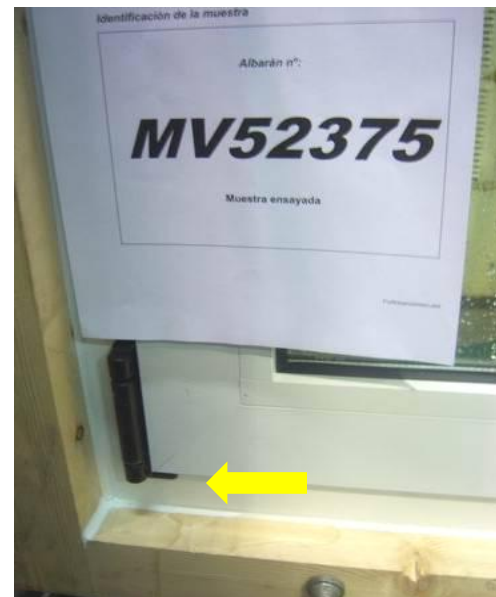
Zona de infiltrações de água
