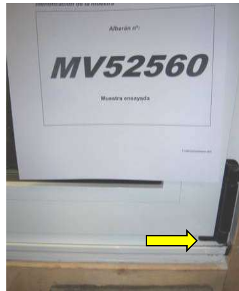
Zona de filtración de agua
