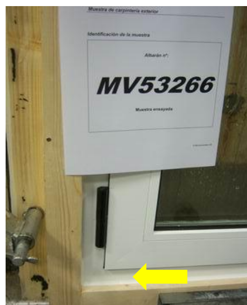
Zona filtración de agua
